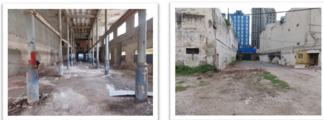
Figura 4. Estado de las parcelas en la primera inspección (Parcelas 2 y 3).
