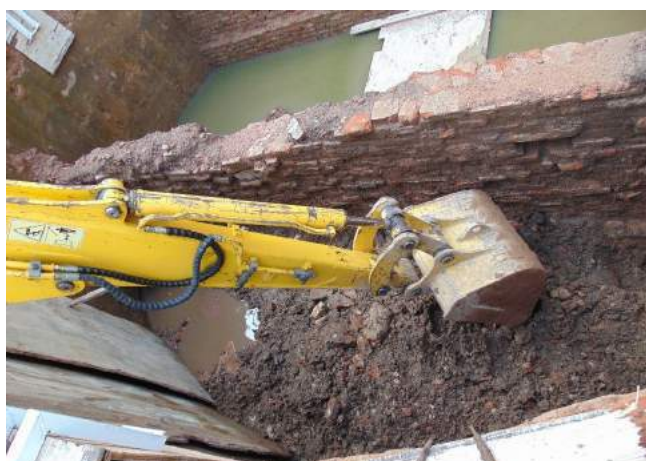
Figura 1: fenólicos (tablas de madera) ubicados en el lateral de la cisterna mientras la pala de la retroexcavadora retira el relleno de la misma (foto: Dra. Ana Igareta).
