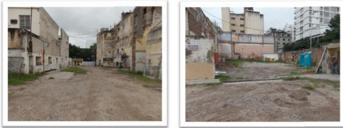
Figura 5. Estado de las parcelas en la primera inspección (Parcelas 18, 12, 9 y 11).
